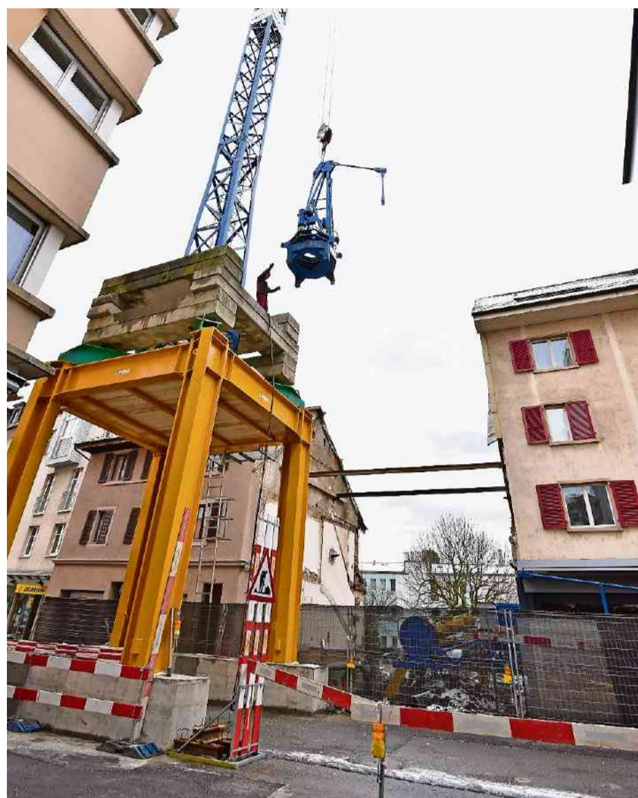
Der Kran ist montiert, nächste Woche geht es mit dem Neubau los.
